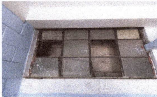
Foto 1. Ventana que se encuentra en el sanitario.
