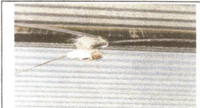
Foto 2. La instalación eléctrica que se debe realizar en el escenario ya que se encuentra en mal estado.
