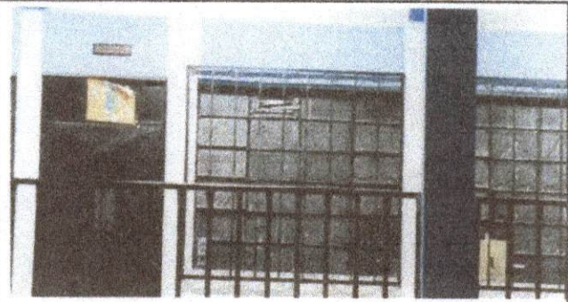
Foto 2. las ventanas que no tien como abrirse para que entre una adecuada ventilación, dentro de los salones de clase.
