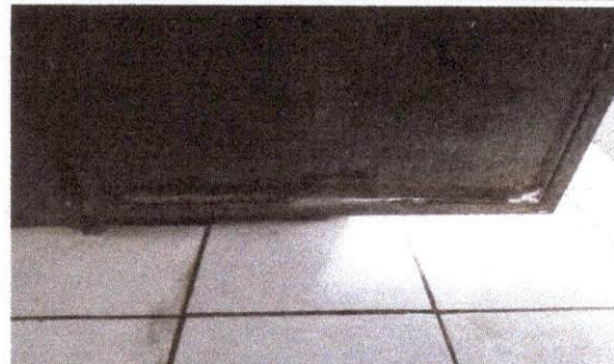
Foto 6. Las puertas que se deben reparar y pintar, de los servicios sanitarios.
