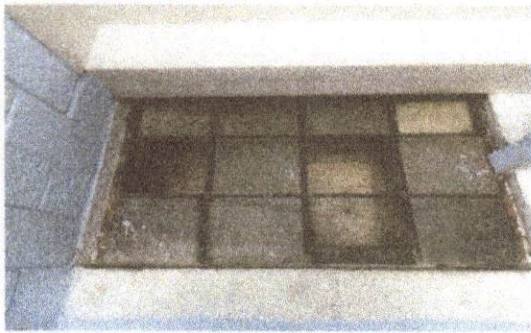
Foto 1. Ventana que se encuentra en el sanitario.
