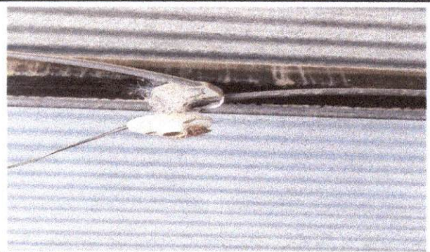
Foto 2. La instalación eléctrica que se debe realizar en el escenario ya que se encuentra en mal estado.
