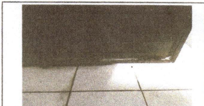
Foto 6. Las puertas que se deben reparar y pintar, de los servicios sanitarios.
