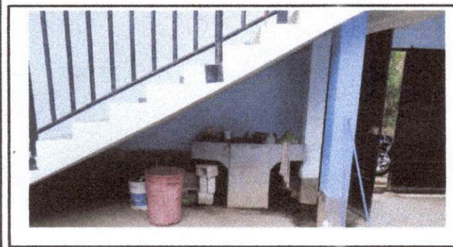
Foto 5. La pila quedo en un mal lugar no se puede utilizar los dos lavaderos uno esta tapado y el otro queda debajo de las gradas. Y se acumula agua en la entrada.
