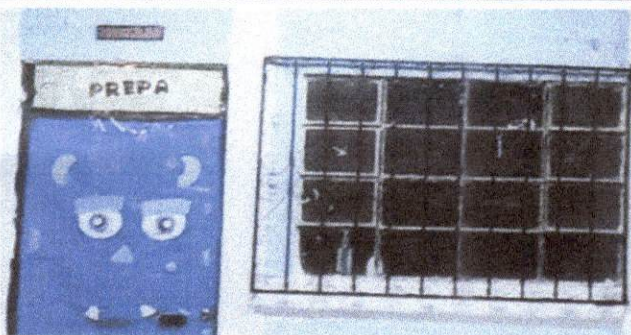
Foto 3. En todos los salones, tanto en el primer nivel como el segundo nivel, se cuenta con este estilo de ventanas que si hay iluminación, pero no hay ventilación porque no se pueden abrir,
