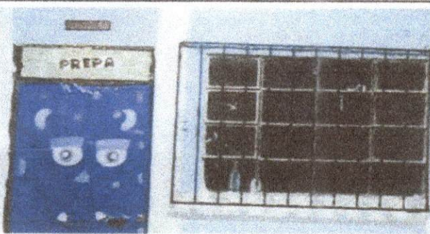
Foto 3. En todos los salones, tanto en el primer nivel como el segundo nivel, se cuenta con este estilo de ventanas que si hay iluminación, pero no hay ventilación porque no se pueden abrir.
