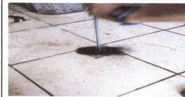
Foto 5. Reparación del drenaje que se encuentra en los sanitarios, ya que es una fosa séptica.
