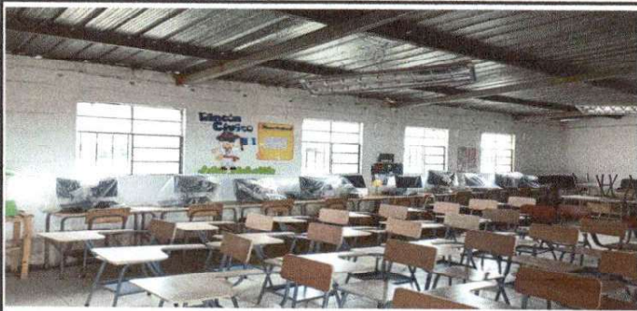
Foto 3: El techo está muy bajo por lo que se encierra el calor y en temporada de lluvia se filtra el agua, ya se realizaron varias reparaciones pero sigue siendo inconveniente.
