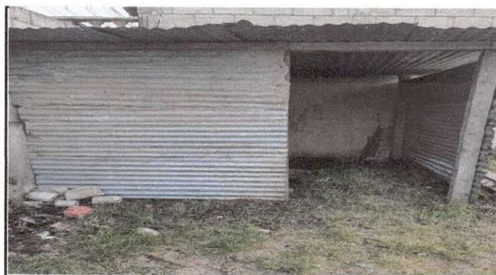
Foto 3: Espacio de cocina en muy malas condiciones.
