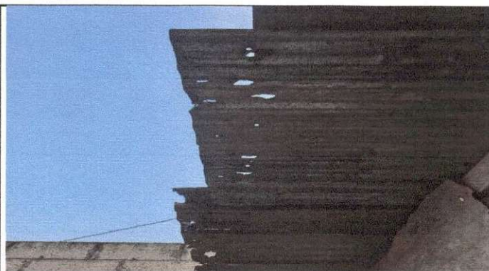
Foto 4: Techo de cocina en muy malas condiciones
