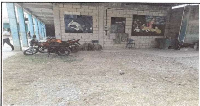
Foto 6: Esta área necesita piso de losa. Vista lateral
