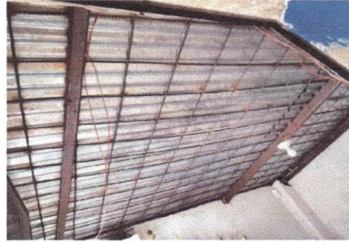
Foto 14: En la presente imagen del modulo 2 se observa la lámina galvanizada de la dirección que se sustituirá con lámina troquelada.
