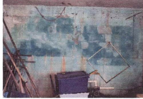
Foto 2: En la presente imagen del modulo 1 se logra observar la humedad y deterioro del muro de la cocina que se impermeabilizará, además de aplicarle sernido, repello y pintura.
