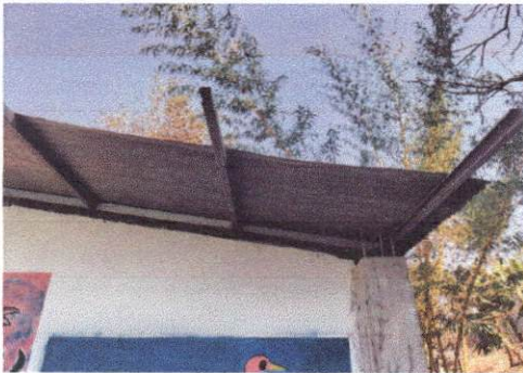
Foto 21: En la presente imagen del modulo 3 se observa la lámina galvanizada del centro de computación que se sustituirá con lámina troquelada.
