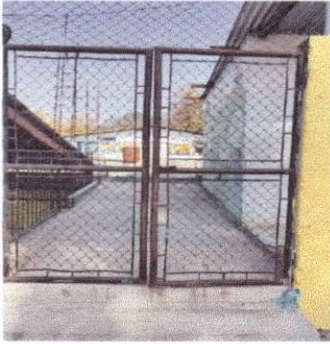
Foto 13: En la presente imagen del modulo 2 se observa la puerta deteriorada que se sustituirá.
