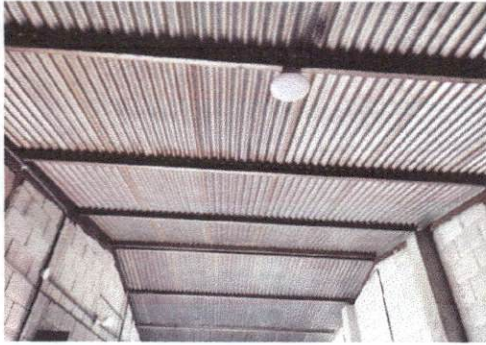
Foto 19: En la presente imagen del modulo 3 se observa la lámina galvanizada del centro de computación que se sustituirá con lámina troquelada.
