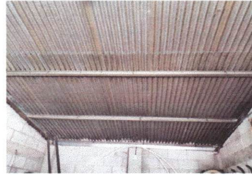
Foto 20: En la presente imagen del modulo 3 se observa la lámina galvanizada del centro de computación que se sustituirá con lámina troquelada.
