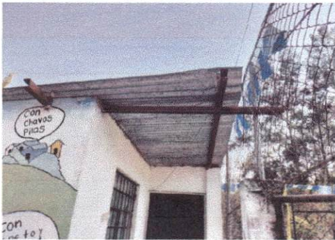
Foto 15: En la presente imagen del modulo 2 se observa la lámina galvanizada de la dirección que se sustituirá con lámina troquelada.
