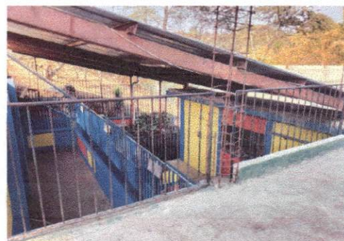
Foto 16: En la presente imagen del modulo 2 se observa la baranda deteriorada a la cual se le dará mantenimiento.
