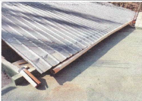
Foto 17: En la presente imagen del modulo 2 se observa la bajada de agua pluvial que se sustituirá por canal de metal.
