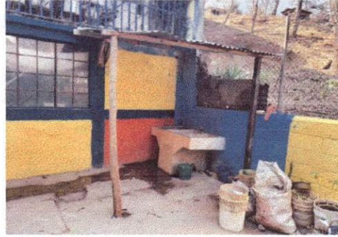
Foto 8: En la presente imagen del modulo 1 se observa el soporte de madera y la lámina galvanizada que se sustituirá.
