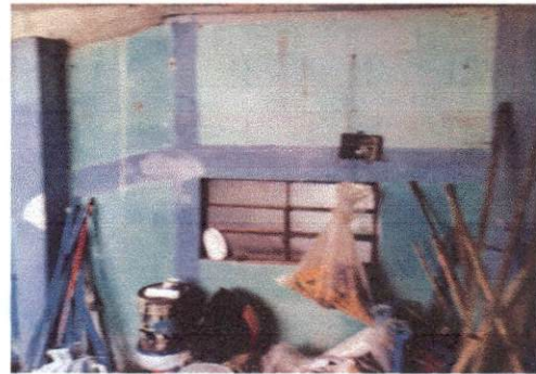
Foto 4: En la presente imagen del modulo 1 se observa la pared a la cual se le aplicará sernido, repello y pintura.
