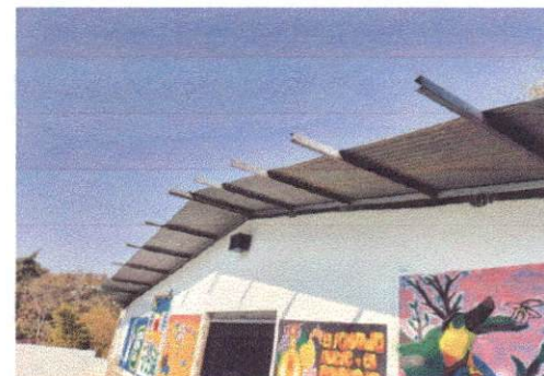
Foto 22: En la presente imagen del modulo 3 se observa la lámina galvanizada del centro de computación que se sustituirá con lámina troquelada.
