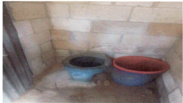
Foto 10: IMAGEN ACTUAL DE PAREDES DE SANITARIOS
