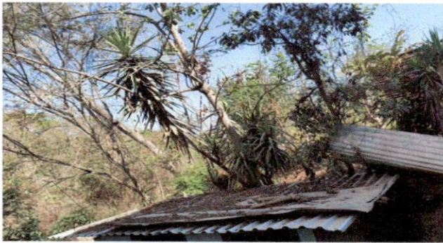
Foto 9: IMAGEN ACTUAL DE TECHO DE LÁMINA DE SANITARIOS
