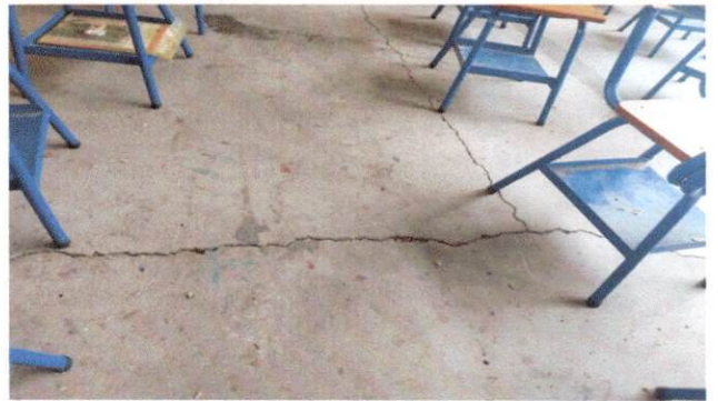
Foto 8: IMAGEN ACTUAL DE PISO DE TORTA DE CEMENTO DE SALÓN 4
