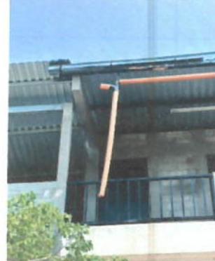
Foto 8: Bajadas de agua rotas debido a la cristalización del materia de PVC
