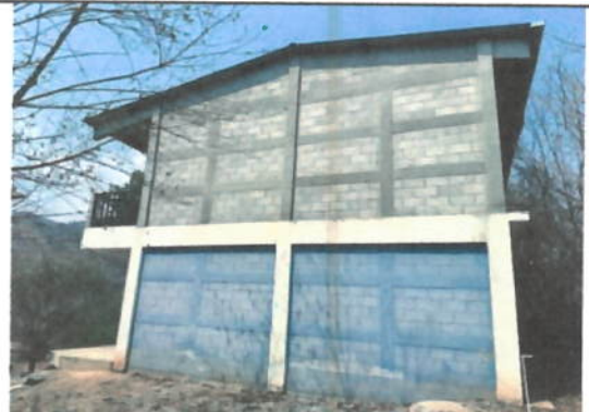
Foto 10: La escuela presenta deterioro a nivel externo por lo que se necesita realizar la pintura en todo el exterior.
