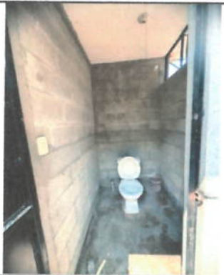
Foto 9: Los baños no cuentan con piso ni azulejo.
