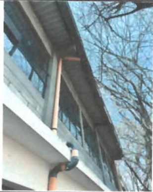
Foto 7: Las bajadas de agua se han cristalizado y en su mayoría se han roto por lo que se deberán sustituir.
