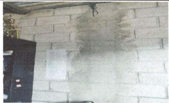
Foto 4: Imagen que muestra el estado actual de las paredes.
