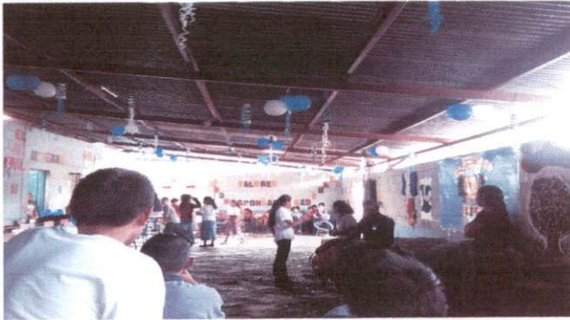
Foto 1: Área donde se realizara reparación de techo.
