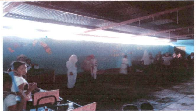
Foto 2: Área donde se realizara reparación de techo.
