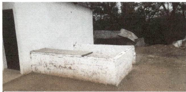
FOTO 4 LA COCINA NECESITA PINTURA Y AZULEJOS
