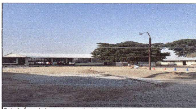
Foto 6: Área de la cancha y patio del establecimiento que necesita reparación con torta de concreto.
