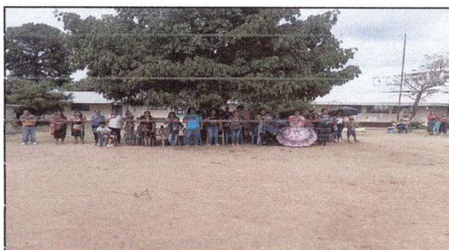
Foto 4: Área de la cancha y patio del establecimiento que necesita reparación con torta de concreto.
