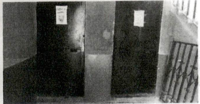
Foto 16: MANTENIMIENTO Y PINTURA DE PUERTAS DE SANITARIOS DE PRIMER NIVEL, DIRECCIÓN Y SALÓN DE MAESTROS
