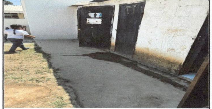
Foto 2: Frente de los baños de los niños de párvulos, las puertas necesitan un cambio, ya que por el agua se han deteriorado
