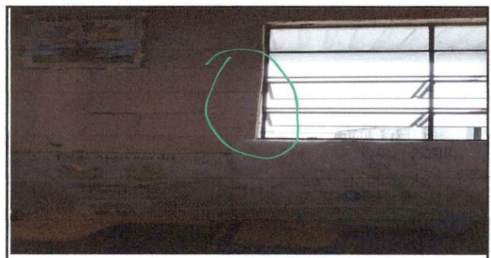
Foto 12: La estructura de las ventana esta deterrioradad y puede causar accidentes con los estudiantes
