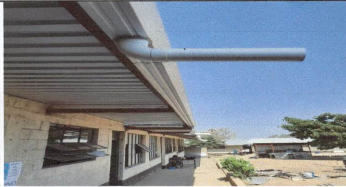
Foto7: Frente los módulos 3, 4, 5, 6 y 7, son cinco clases se deben reparar las bajadas de agua pruvial
