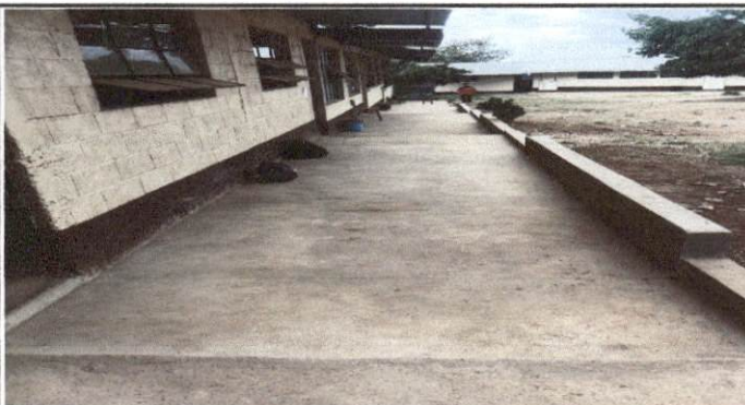
Foto 9: La reparación y desnivel de la cuneta de concreto, ya que en tiempo de lluvia, no fluye de forma correcta
