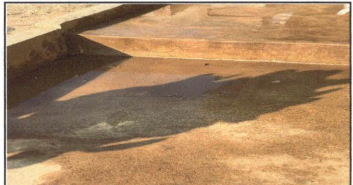
Foto 10: La acumulación de agua por la falta de profundidad he inclinacion de la cuneta de concreto
