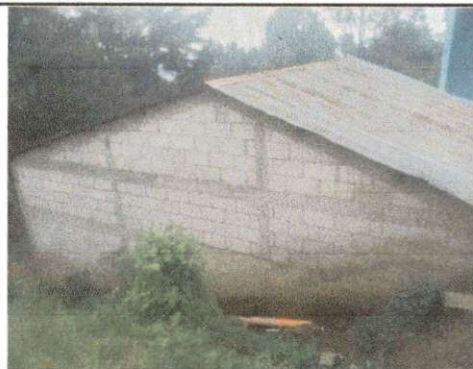
Foto 2: Repello de pared dañada por la humedad.
