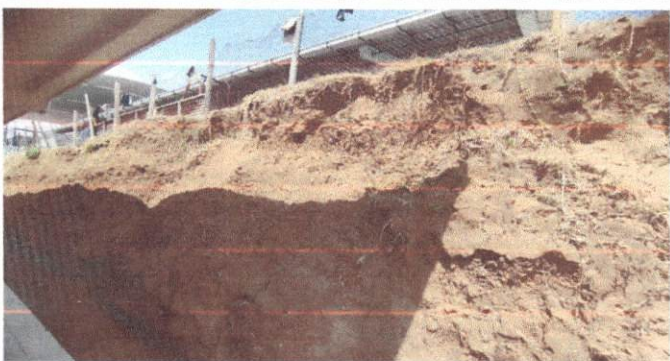
Foto 3: Area afectada por erosión del terreno.
