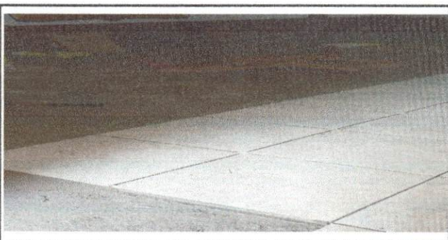
Foto 6: Sustrucción de torta de cemento por piso cerámico en el salón de Preprimaria.
