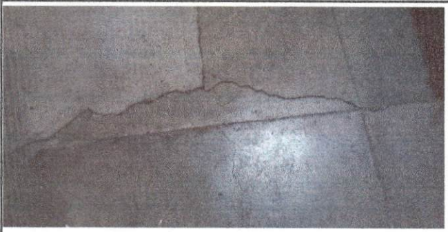
Foto 3: Sustracción de torta de cemento por piso cerámico en el salón de Tercero Primaria.
