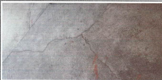
Foto 5: Sustracción de torta de cemento por piso cerámico en el salón de Sexto Primaria.
