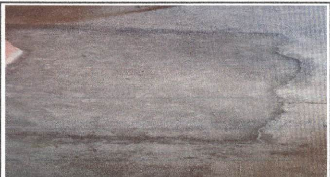
Foto 2: Sustracción de torta de cemento por piso cerámico en el salón de Segundo Primaria.
