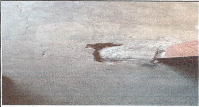
Foto 1: Sustracción de torta de cemento por piso cerámico en un salón que ocupa la Dirección.
