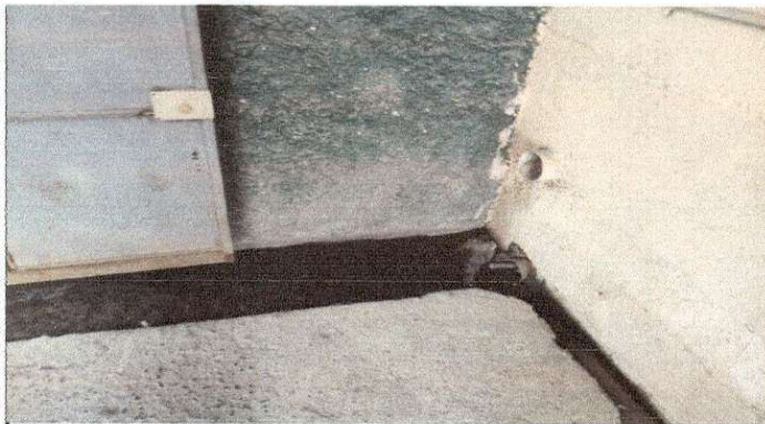
Foto 3: Mantenimiento de reposadera.
