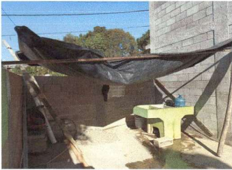
Foto 1: La cocina esta en condiciones inadecuadas, necesita instalación 4 hiladas de block, colocarle losa, piso, ventanas, electricidad, puerta y pila.
