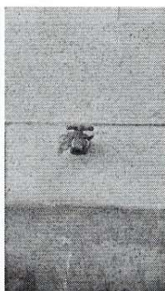
Foto 5: Se necesita sustitución de tubería línea principal, sustitución de contador y llave de chorro
