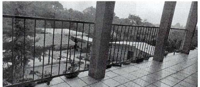
Foto 4: Se necesita mantenimiento de barras de metal
