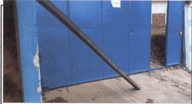
Foto 5: Losa de entrada y patio deterioradas
