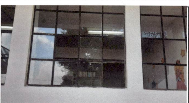
Foto 6: Faltan vidrios de las ventanas y quebradas
