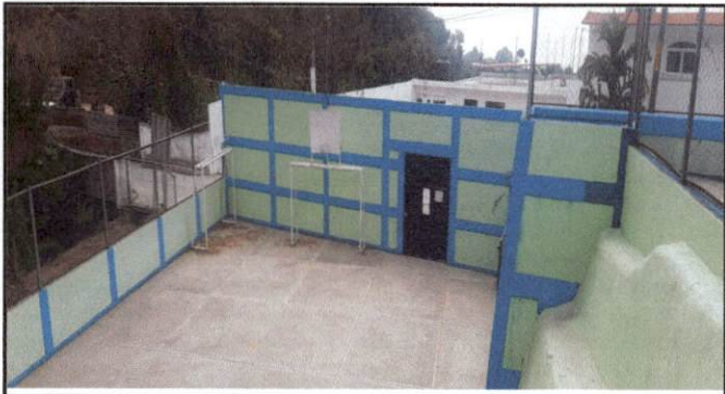
Foto 3: Pintura deteriorada de muro interior de la escuela
