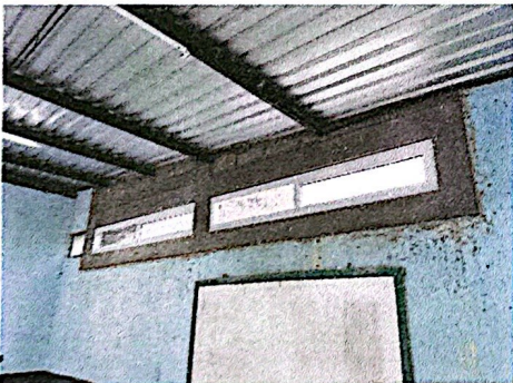
Foto 3: Apertura de vano en salón de clases + suministro e instalación de ventana UPVC.
