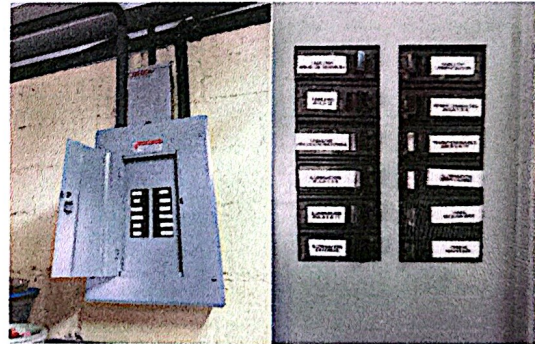
Foto 4: Tablero de distribución + caja de protección RH.
