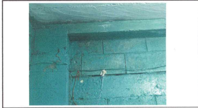
Foto 4: humedad en salon
