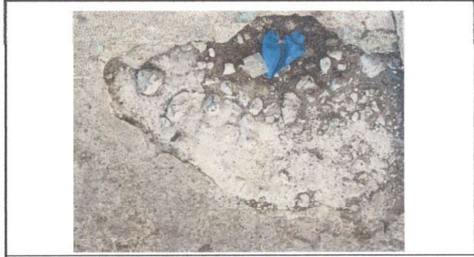
Foto 2: Pisos de cemento deteriorado salones y patio
