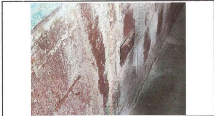
Foto 3: paredes de salones con humedad
