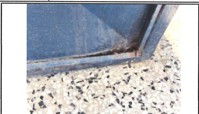
Foto 8: Se muestra el daño causado por el oxido a las puertas.
