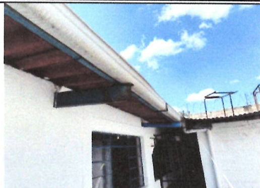
Foto 2: Se puede apreciar la deflexión en los canales pluviales.
