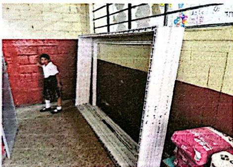
Foto 9: Ventanas de UPVC.
