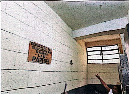
Foto 3: Es necesario realizar la apertura de un vano, con ventana tipo sifón para mejorar la ventilación e iluminación en el servicio sanitario.
