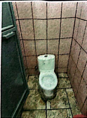
Foto 5: Inodoro en mal estado en el baño de niñas.
