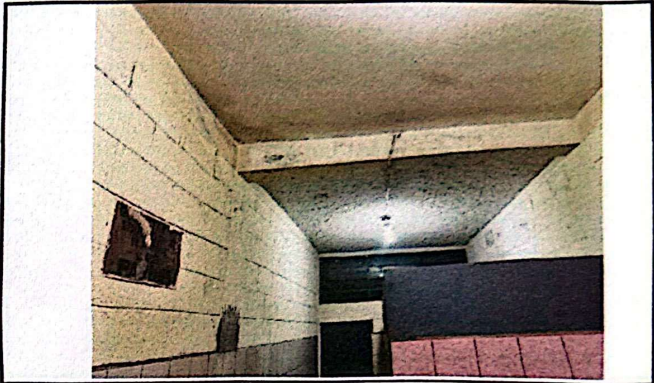
Foto 8: Coincide la mancha de humedad en el muro que colinda con servicio sanitario de hombres por lo que refuerza la teoría de fuga en tubería empotrada en pared.
