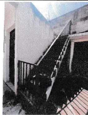
Foto 12: Baranda de escaleras con pintura en mal estado.
