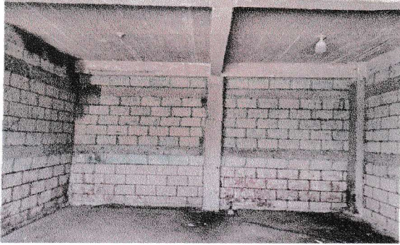
Foto 7: Interior de un aula con pintura en mal estado
