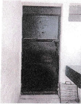
Foto 9: Puertas con pintura en mal estado.
