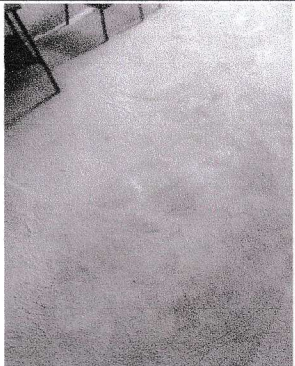
Foto 4: Torta de concreto en bodega, sin piso.
