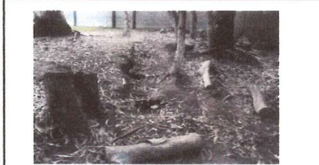
Foto 3: Erosión de tierra
