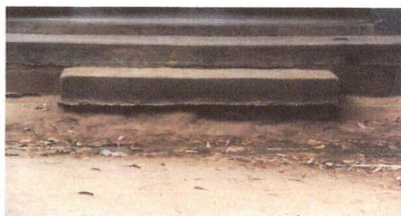
Foto 9: Erosión de tierra, por no tener canales.
