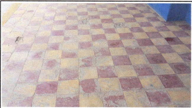
Foto 11: Fotografía de piso en mal estado
