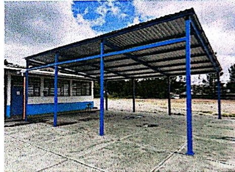
Foto 10: Armado de estructura para ampliación de techo con instalación de lámina troquelada calibre 26.
