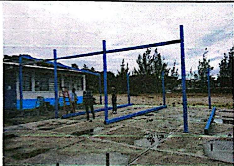
Foto 9: Preparación de estructura metálica para ampliación de techo, se rectifica el nivel para garantizar la verticalidad de los elementos.
