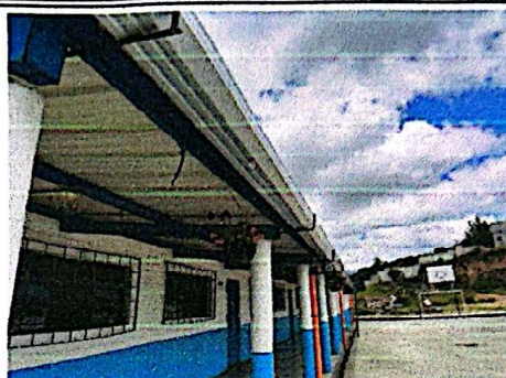
Foto 8: Suministro e instalación de canal pluvial + bajadas de agua corroborando que los cargadores brinden un soporte apropiado.
