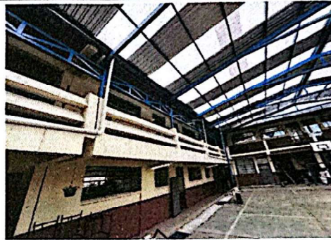
Foto 10: Bajadas de agua, con tubería PVC.
