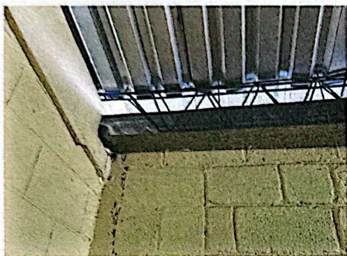
Foto 7: Canal pluvial que presenta problemas de filtración.
