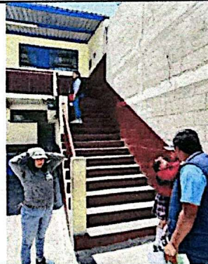
Foto 10: Los niños actualmente se mojan al momento de subir a los salones de clases, por lo que la ampliación del techo ayudaría a mitigar ese problema.
