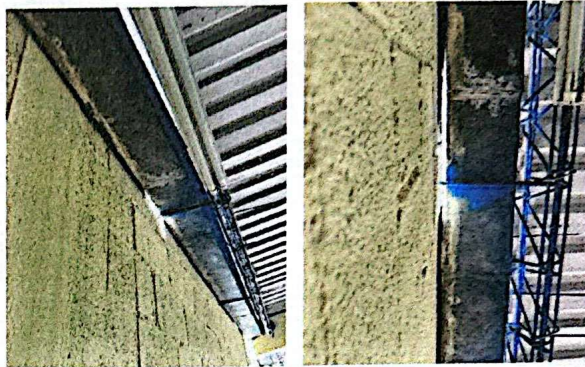
Foto 8: Como se puede apreciar el sello entre el canal y el muro es inexistente por lo que el agua escurre por la pared en época de lluvia.
