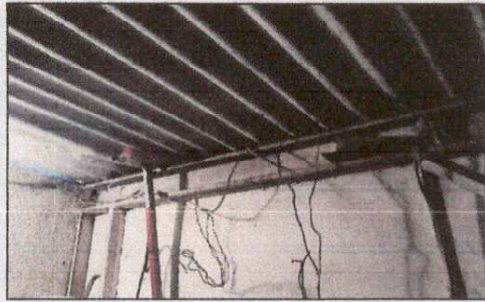
Foto 7. Arreglar instalación eléctrica
