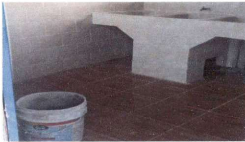
Foto 1: Se selló la reposadera que causaba inundación dentro de la cocina.
