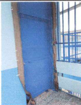
Foto 23: Pintura en puertas.
