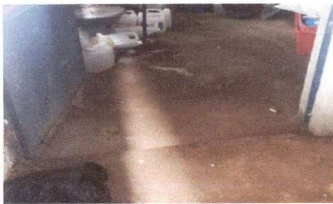
Foto 5: Colocar piso cerámico como prevención al deterioro de la fundación.
