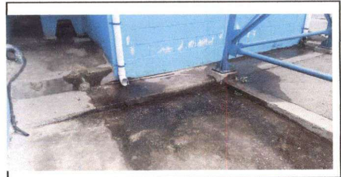
Foto 12: Modificar las bajadas de agua para evitar mantener el área húmeda y resbalosa.
