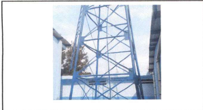
Foto 15: Reparación e instalación nueva ya que hay constante fuga el tinaco principal de agua.
