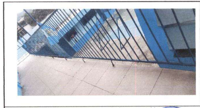
Foto 18: Reforzar barandal del segundo nivel, no es estable, es peligro para los alumnos.
