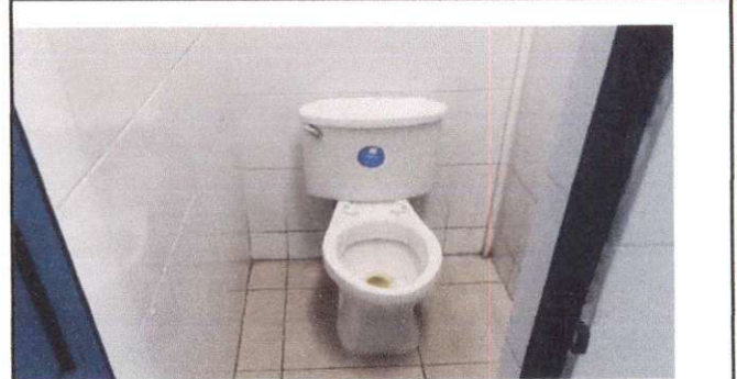
Foto 10: Colocar tapaderas a los sanitarios para mayor higiene.
