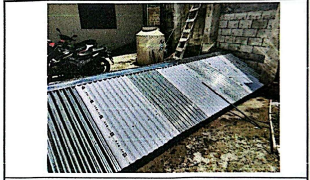
Foto 10: Enlaminado en techo de bodega.
