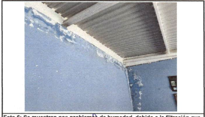
Foto 6: Se muestran nos problemas de humedad, debido a la filtración que existe en la unión del techo el muro.
