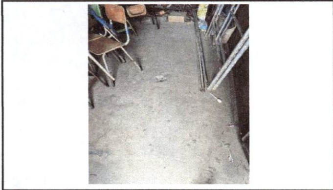
Foto 3: No se cuenta con piso en los salones.
