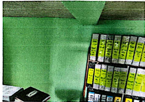
Foto 10: Aplicación de pintura en área de oficina que presentaba problemas de humedad por la filtración en junta de dilatación.
