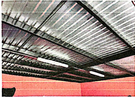
Foto 7: Se puede apreciar el mantenimiento a la estructura de soporte y la colocación de las láminas nuevas.
