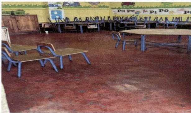
Foto 3: SUMINISTRO Y COLOCACION DE PISO CERAMICO ANTIDESLIZANTE PARA AREA DE NIÑOS DE PREPRIMARIA DEL CENTRO EDUCATIVO.
