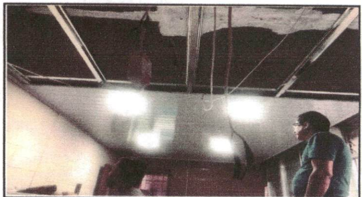
Foto 4: Imagen que muestra el estado de desmontaje y puesta de cielo falso área administrativo: Secretaria, contabilidad, dirección, subdirección y dos bodegas.
