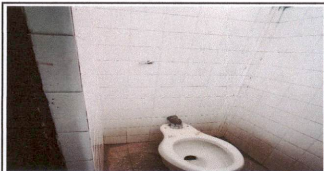
Foto 6: En el área de sanitarios se tiene que acarrear agua para su limpieza, necesitándose reparar las tuberías para que los alumnos no tengan que acarrearla y así se mantenga seca el área.
