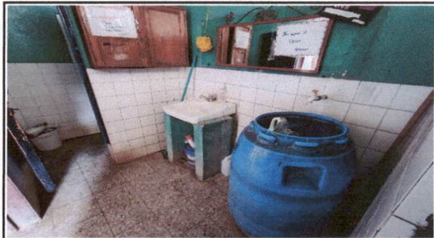
Foto 4: El servicio sanitario de alumnas carece de espacio suficiente para lavarse las manos; y el mal estado de la tubería potable provoca a que tengan que acarrear agua de un tonel.
