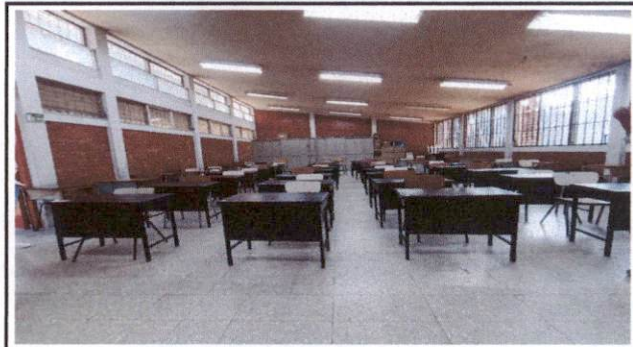
Foto 2: Área de comercio, se necesita reparar la instalación eléctrica, agregar nuevos tomacorrientes y reforzar las puertas de acceso para ampliar el laboratorio de TACs.
