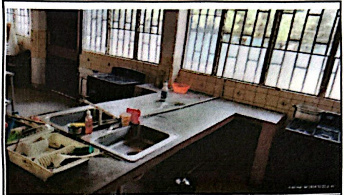
Foto 2: La fotografía corresponde a la primera isla instalada en el taller de cocina y repostería, desde su fabricación quedó con blanqueado de cemento, actualmente tiene deterioro y debe ser cubierta con piso cerámico
