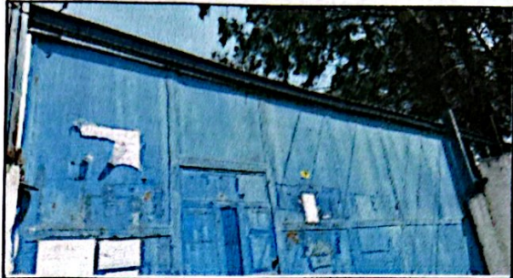
Foto 2: EL PUENTE QUE CARGA NAL PORTÓN ESTA VENCIDO NECESITA REFUERZO Y CAMBIO DE RODOS
