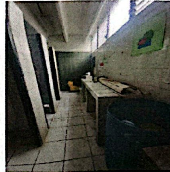
Foto 4: Los lavamanos estan tapados en el sistema de drenajes, necesita la reubicación para colocar 3 uriniales para varones.
