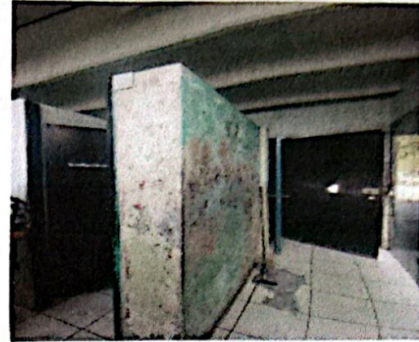
Foto 2: Area de sanitarios para varones, se deterioró el azulejo.
