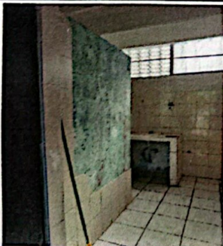
Foto 5: La instalación del azulejo despues de 20 años se cayó y se necesita instalar nuevamente para el tema de higiene.
