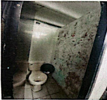
Foto 3: El azulejo de las paredes se cayó y la acometida de agua potable se taó por sarro, falata pintura y sistema de lumnlación eléctrica.
