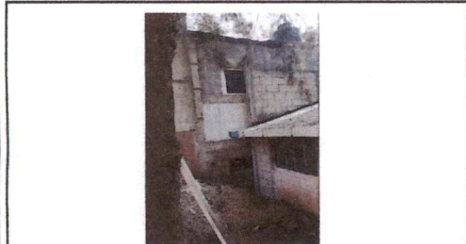
Foto 3: Reparación de muro perimetral, que pone en riesgo la integridad de los alumnos, debido a la inseguridad; colindante con los vecinos.
