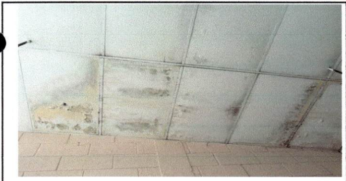
Foto 3: Imagen que muestra el estado actual del cielo falso afectado por la filtración de agua pluvial en área administrativa
