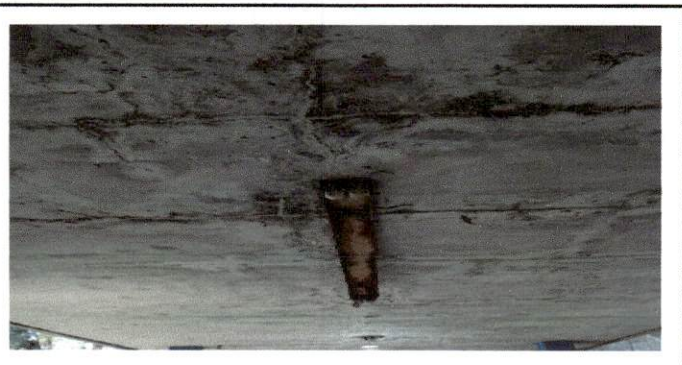
Foto 4: imagen que muestra el estado actual de las instalaciones eléctricas del corredor del establecimiento
