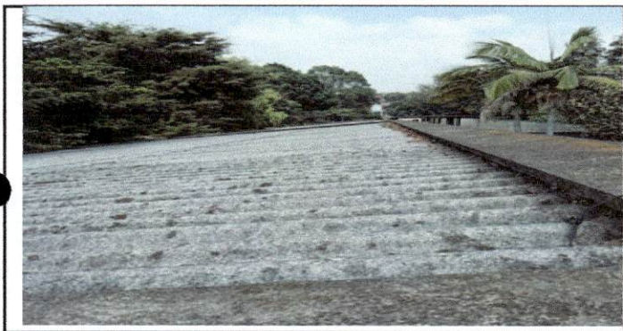
Foto 5: Imagen que muestra el estado actual de duralita afectado por la filtración de agua pluvial en área administrativa
