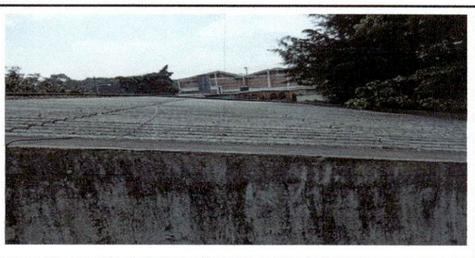
Foto 6: Imagen que muestra el estado actual lateral del módulo administrativo afectado por la filtración de agua pluvial
