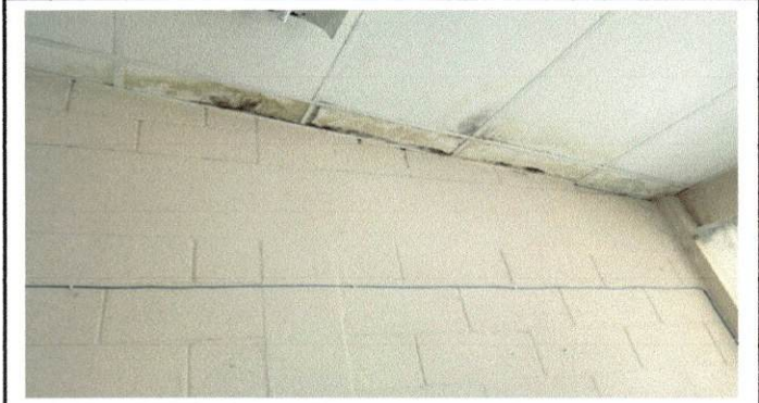
Foto 1: imagen que muestra el estado actual del cielo falso afectado por la filtración agua pluvial en el área administrativa .
