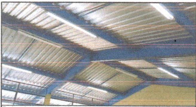
Techo, pintura e instalación eléctrica terminada en el aula de quinto B
