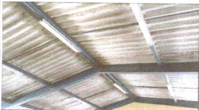
Foto 3: Interior del techo, aula de 2do B
