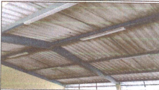
Foto 2: Interior del techo, aula de 2do B
