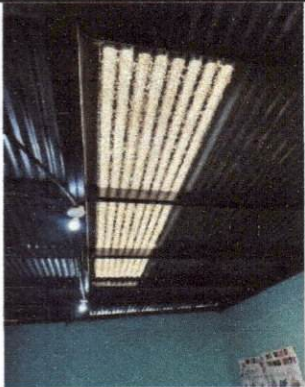
Foto 7: En las aulas se tiene poca iluminación natural.
