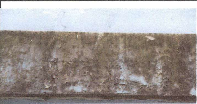
IMAGEN DEMUESTRA EL DETERIORO DE LAS BASES DEL SEGUNDO NIVEL, LAS CUALES SE DETERIORAN POR FALTA DE CANALES
