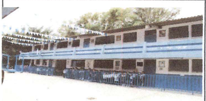
ESTE ES EL EDIFICIO MODULO 2 QUE NECESITA CAMBIO DE TECHO DURALITA POR TECHO DE LAMINA GALVANIZADA.
