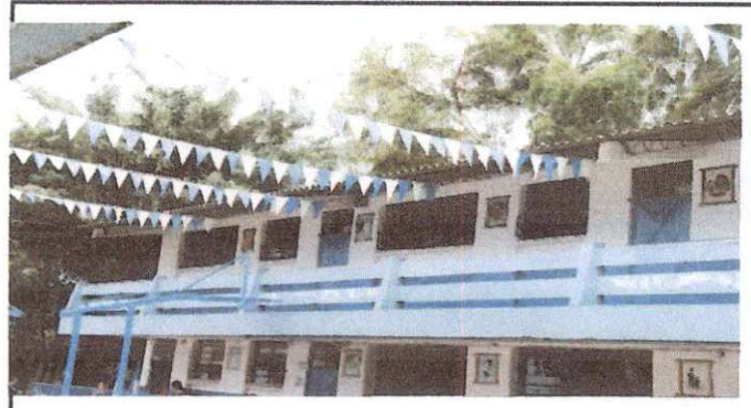
ACA PODEMOS APRECIAR QUE EL MODULO 2 ESTA COLAPSADO DEL TECHO ES DURALITA Y SE CUELA LA LLUVIA, ASI COMO LA NECESIDAD DE COLOCAR BAJAS DE AGUA POR MEDIO DE CANALES.
