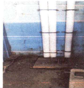
Foto 6: Filtración de agua y crea humedad.
