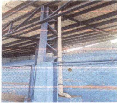
Foto1: Tubos muy pequeño en recepción de agua llovediza
