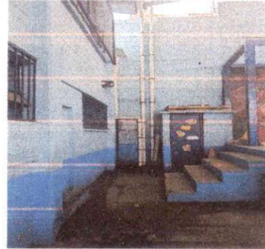
Foto 2: Tubería sin gran capacidad para la distribución de agua llovediza y provoca inundaciones
