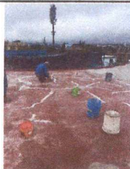
Foto 6: MODULO 2, IMPERMEABILIZACION DE LOSA, AULA DE DIRCCION J.V., BAÑO DE DOCENTES, COCINA DE LA TARDE Y BAÑO DE NIÑAS.
